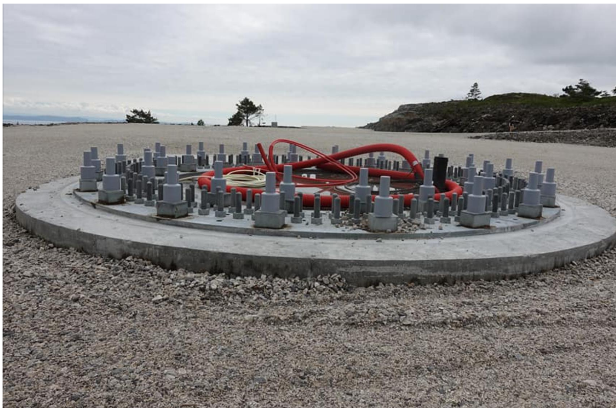
Turbinpunkt Tysvær vkv som viser at fundamentet er «løftet» opp over terrenget
